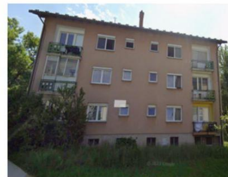
Slika: Fasada pred prenovo
